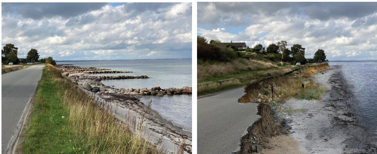
Figur 13. Billede og visualisering af Kystvejen efter der er eroderet ca. 14 m af kysten i 2070. Sammen med vejen forsvinder infrastruktur som vandforsyning, el, tele og kloak.
